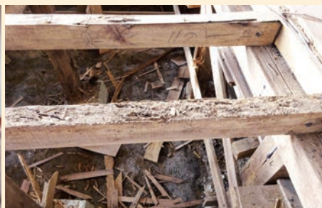
床下の部材には深刻なシロアリ被害が…
